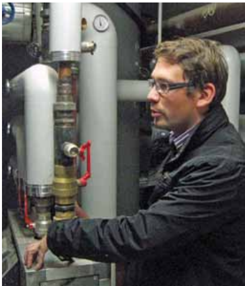
Slika 6 Vodja tehnične službe Sonnenkraft Tadej Mrak je predstavjal tehnične lastnosti solarnih pretočnih grelnikov za pripravo tople vode
