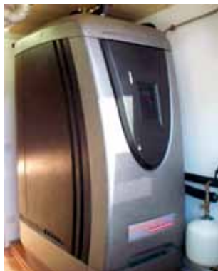
Slika 11 Solar compleet: za izolacijo se skrivajo: hranilnik toplote, TČ, moduli za pripravo tople vode in moduli za ogrevalne kroge, vključno z nadzornim sistemom ... Na to so priključeni še SSE in zunanja enota TČ
