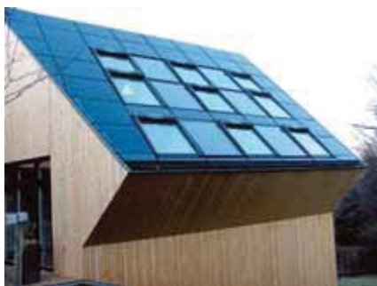
Slika 9 Celotna jugozahodna strešina je prekrita s fotovoltaičnimi moduli in sprejemniki sončne energije
