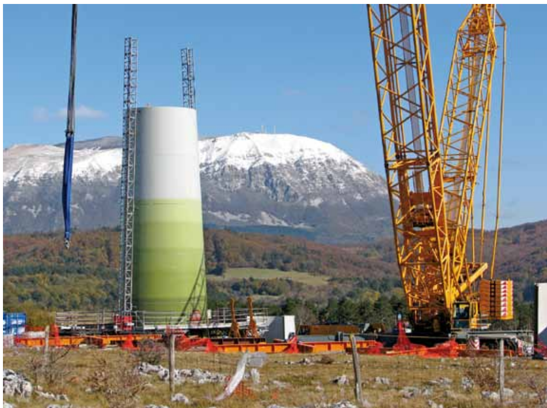
Slika 4 Gradnja prve vetrnice vetrne elektrarne Dolenja vas pri Senožečah ob ustavitvi gradnje zaradi razveljavljenega gradbenega dovoljenja; v ozadju zasneženi Nanos, 27. oktober 2010
