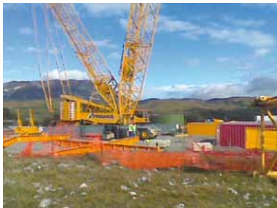
Slika 1 Gradnja vetrnice je v celoti delo tujih rok. Enerkon dobavlja in montira vetrno elektrarno. Še viličarist govori le nemško. Na tabli gradbišča sta med izvajalci napisana le še samostojni podjetnik Filipič iz Sežane in Elektro Primorska. Mar slovenska gradbena industrija ni sposobna narediti bolje, ceneje in hitreje?
